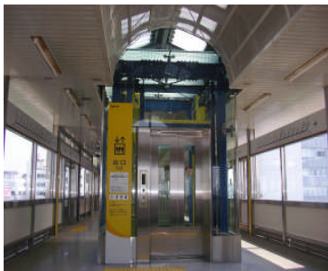
福浦駅エレベーター
